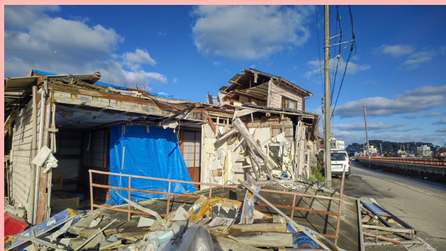
2024/1 能登半島地震被災家屋（輪島市）
